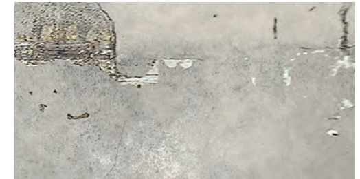
7437 Verwitterte Mauer Weathered wall. Mur patiné.
